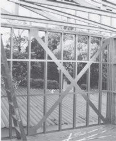
Foto 3.3 - Painel com contraventamento em “X”
